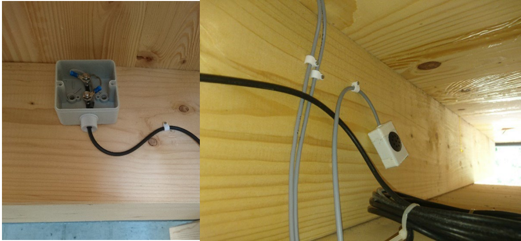
Abbildung 73: Holzfeuchtesensoren mittels Widerstandsmessmethode an Querträger bei Auflager Auenstein (links)
