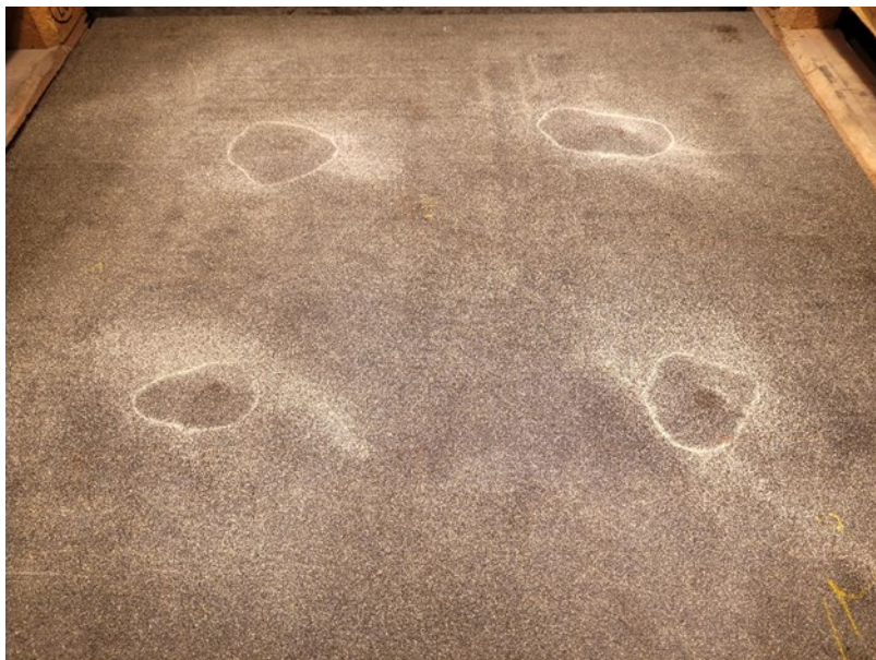
Abbildung 49 : Blasen an Fehlstellen in der EP-Versiegelung ; die Wärmebeanspruchung erfolgte auf der PBD ohne MA-Schutzschicht
