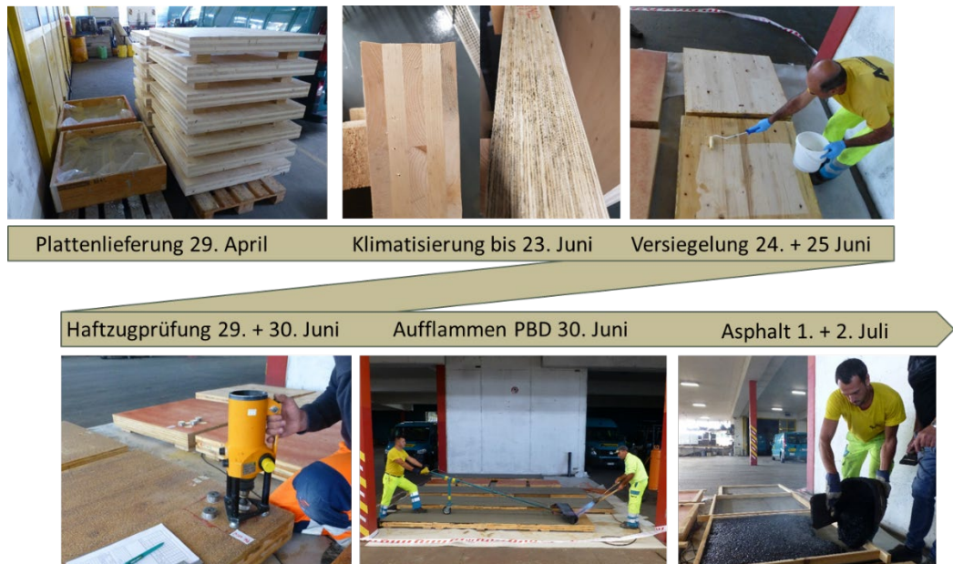
Abbildung 18: Darstellung des Ablaufs der Prüfserie 02 im Werkhof der Aeschlimann AG in Zofingen (AG), von Plattenlieferung bis zum Asphalteinbau
