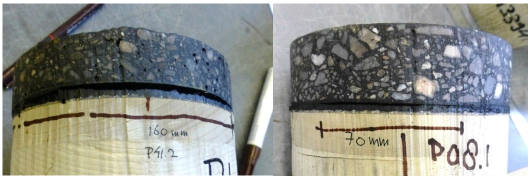
Abbildung 39: Unterschiedliche Arten von Delaminierungen / Blasenbildungen auf Bohrkern P41.2 und P08.1
