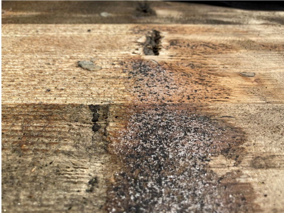
Abbildung 96: Oberflächenstruktur der Fahrbahnplatte nach Entfernen der Epoxidharzgrundierung mittels Schleifen (Variante 1) im rechten Bildbereich und mittels Sandstrahlen (Variante 2) in der linken Bildhälfte
