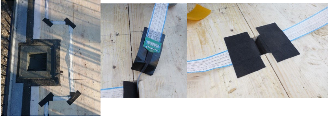
Abbildung 65: Sensorbänder «smartex dm» bei einem Einlaufschacht (links)
