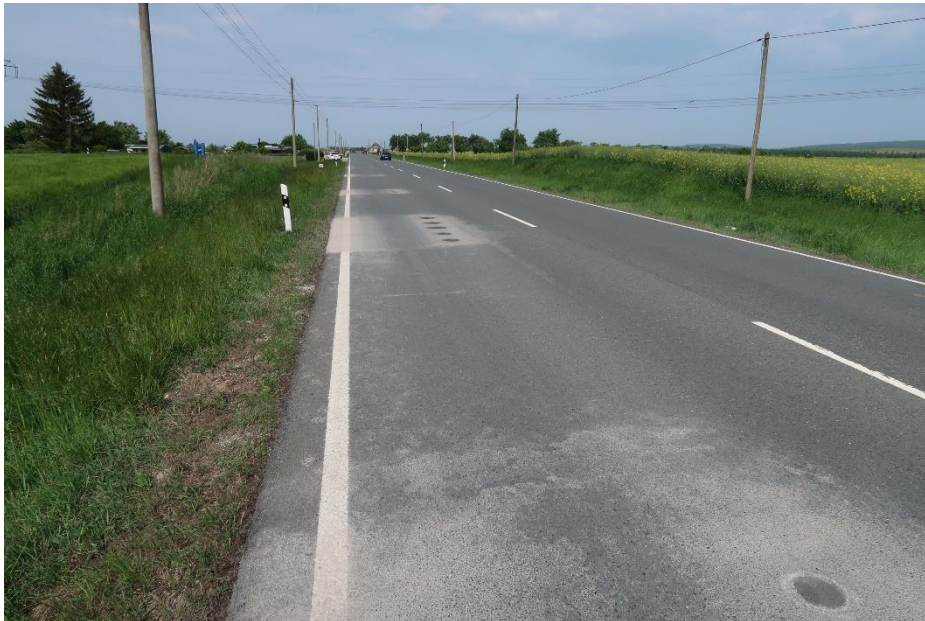
Abbildung 18: Probestrecke L3080 am Tag der Bohrkernentnahme von Variante P im Jahr 2018, die 5er-Cluster sind deutlich zu erkennen.
