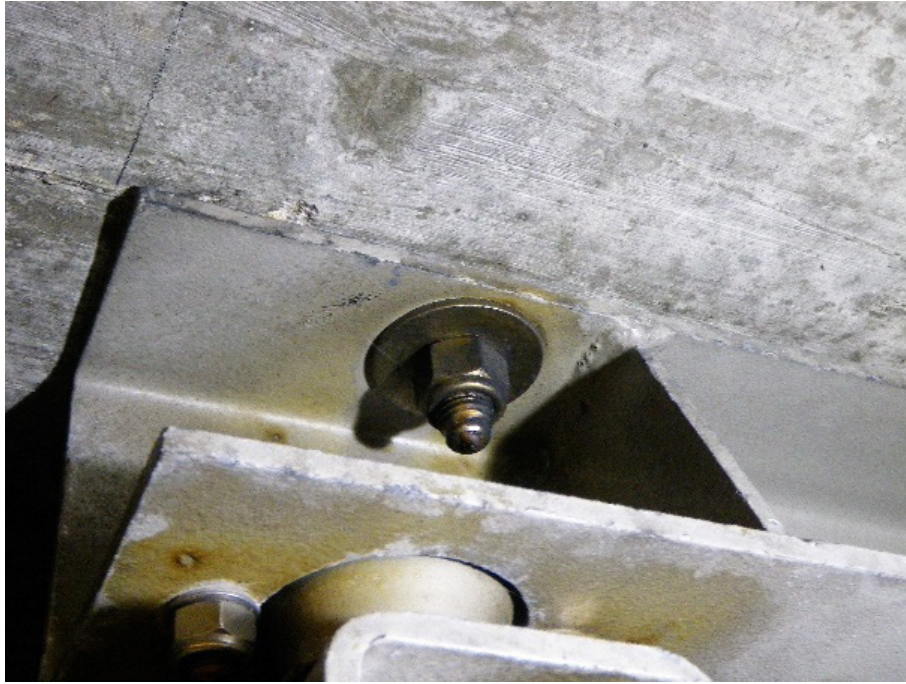
Abb. 36 Tunnel Entlisberg, Aufhängung Strahlventilator, Befestigungselement aus 1.4529, dunkel verfärbt
