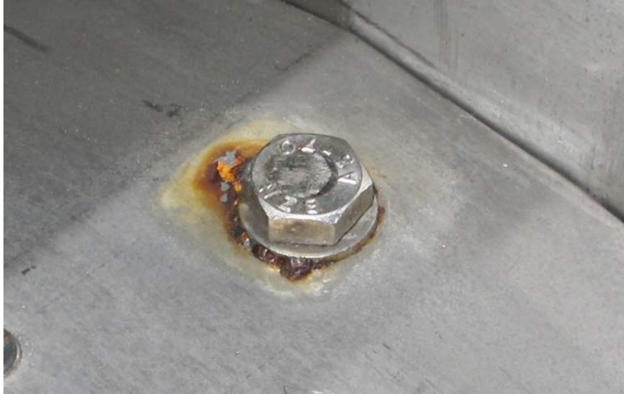
Abb. 23 Aeschertunnel Brandklappe, Schraubverbindung
