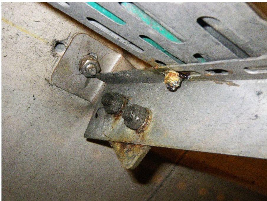
Abb. 33 Tunnel Entlisberg, Kabeltrasse 1.4571 mit Halterung von unten, Korrosionsprodukte bei Spaltsituationen
