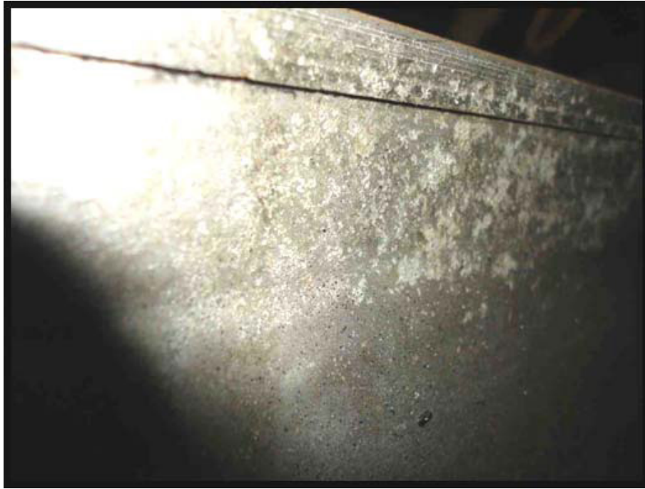
Abb. 28 Gotthardstrassentunnel Abluftklappen, Korrosionsangriffe sind sichtbar nach Reinigung einer Lamelle
