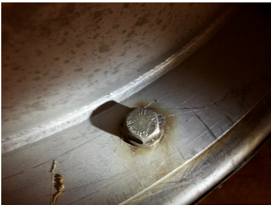
Abb. 39 Tunnel Buchrain, Korrosionsprodukte im Spaltbereich bei einer Schraubverbindung am Gehäuse des Strahlventilators
