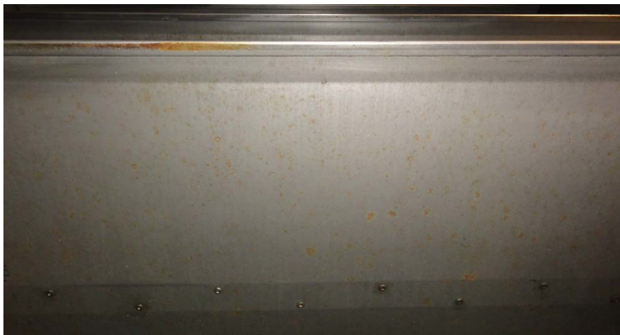
Abb. 24 Aeschertunnel Brandklappe, Lamellenunterseite
