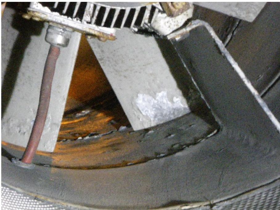
Abb. 35 Tunnel Entlisberg, Detail Rotor SV24, Abplatzung der Beschichtung, weisse Produkte sichtbar
