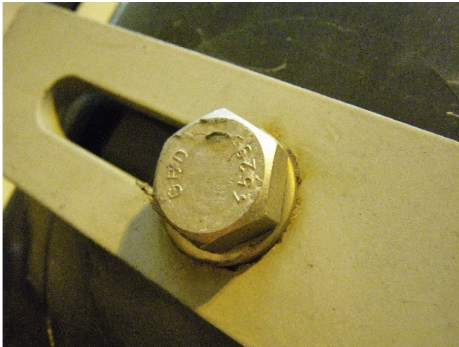
Abb. 32 Tunnel Entlisberg, Schraube aus 1.4529, Korrosionsprodukte im Spaltbereich beim Übergang zum beschichteten nichtrostenden Stahl
