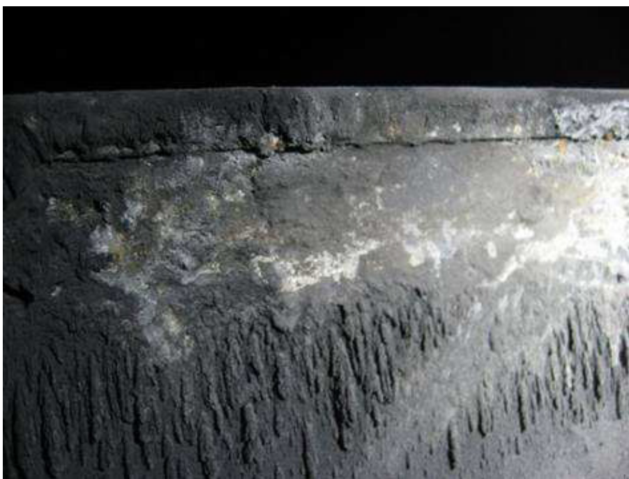
Abb. 27: Gotthardstrassentunnel Abluftklappen, Schmutzablagerungen
