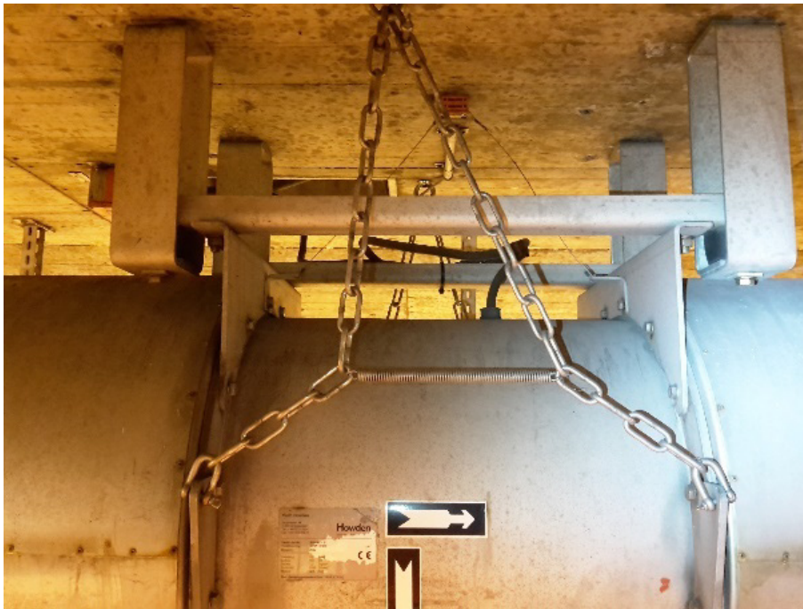
Abb. 38 Tunnel Buchrain, Aufhängekonstruktion des Strahlventilators mit Absturzsicherung
