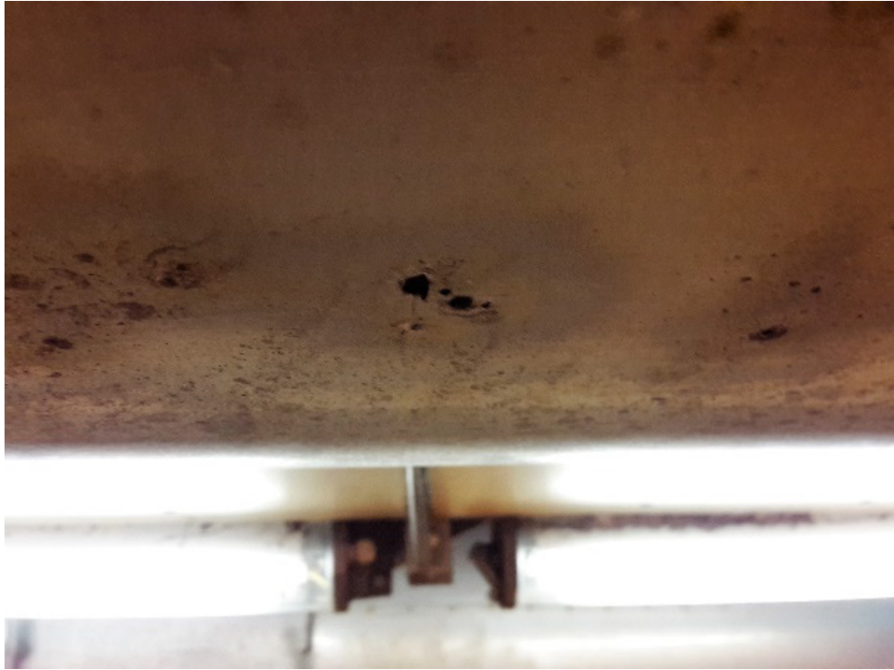
Abb. 40 Tunnel Buchrain, Korrosionsangriffe unten am Schalldämpfer
