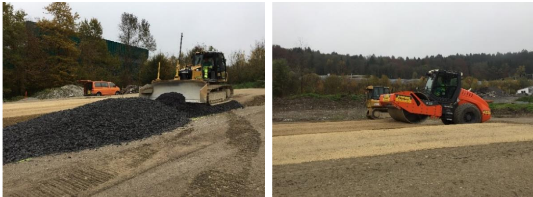
Abb.3 links: Einbau der zweiten Schicht durch einen Trax – rechts: Verdichtung der zweiten Schicht durch eine Kombiwalze
