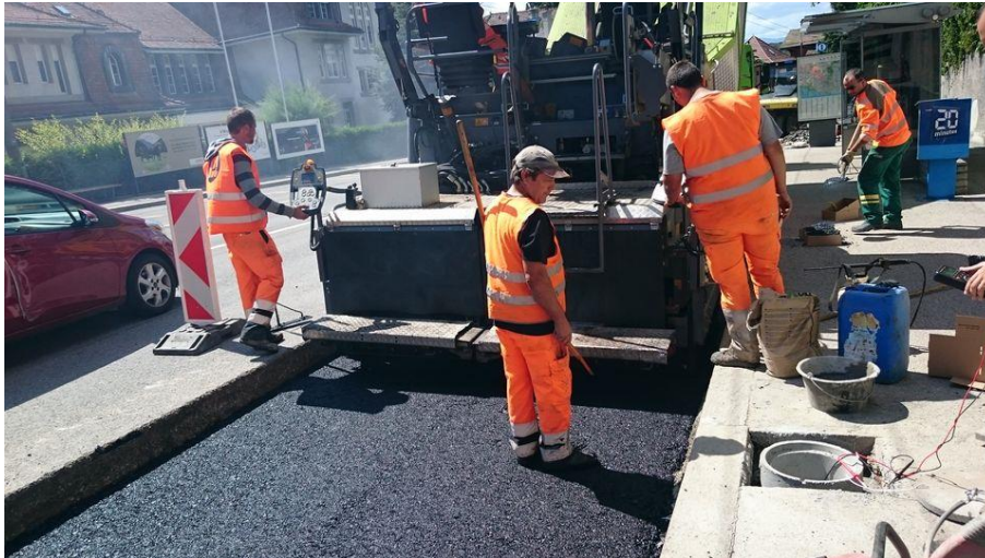
Fig. 18 Pose de la couche bitumineuse en ACT 22 avec vue sur la chambre d'arrivée des câbles des capteurs DMS
