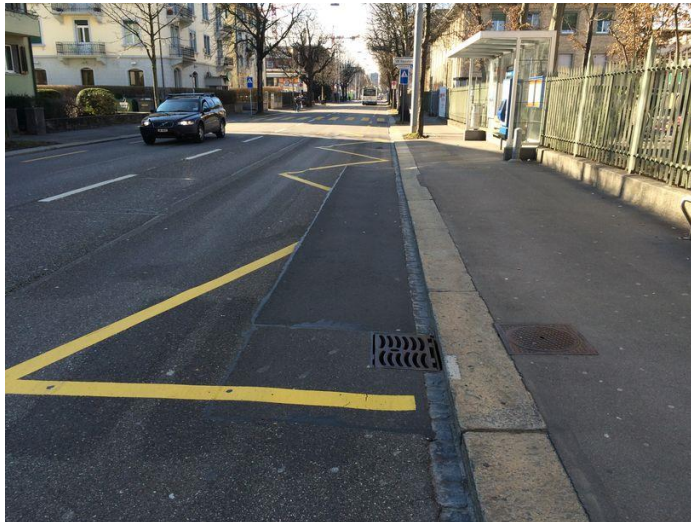
Fig. 22 Chaussée de l'arrêt de bus SBB - Werkstätte avant réfection
