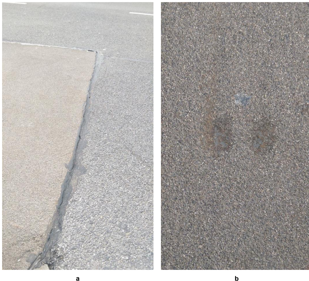
Fig. 46 Dégradations observées en mars 2018 sur l'arrêt de bus à Lausanne : a) ouverture du joint. b) perte de gravillon ponctuelle.
