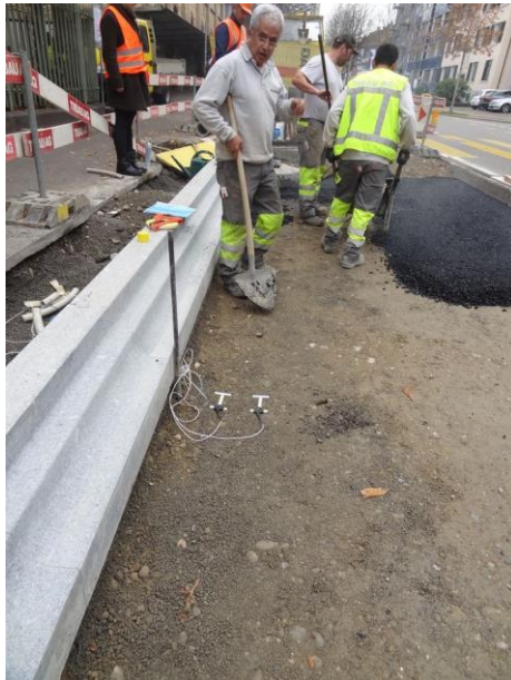
Fig. 25 Pose de la couche bitumineuse en ACT 22 H avec en avant plan les capteurs DMS
