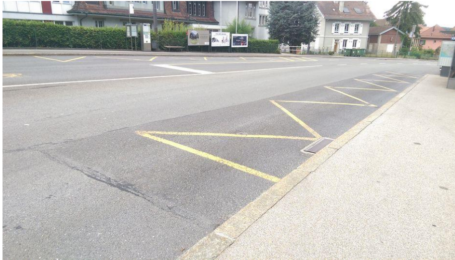
Fig. 16 Chaussée de l'arrêt de bus Foyer (avant réfection)
