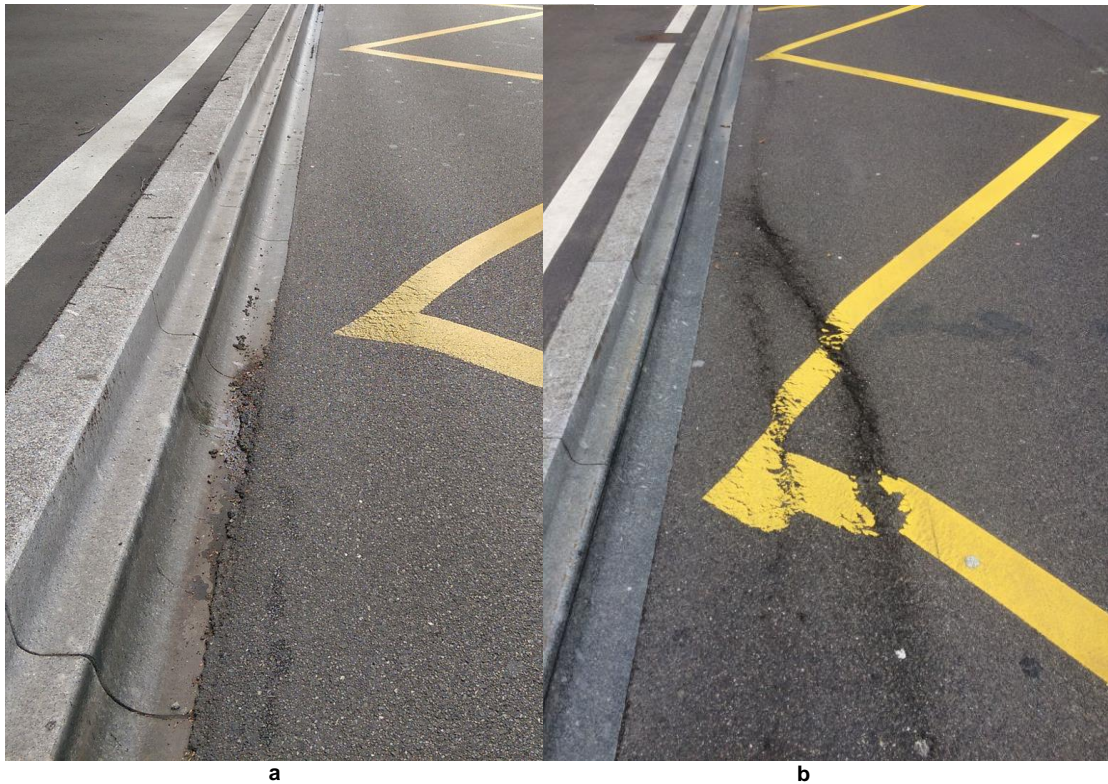
Fig. 47 Dégradations observées sur l'arrêt de bus à Zurich : a) initiation de la déformation de poussée (juin 2017), et b) aggravation de la déformation de poussée et apparition de fissures (mars 2018).
