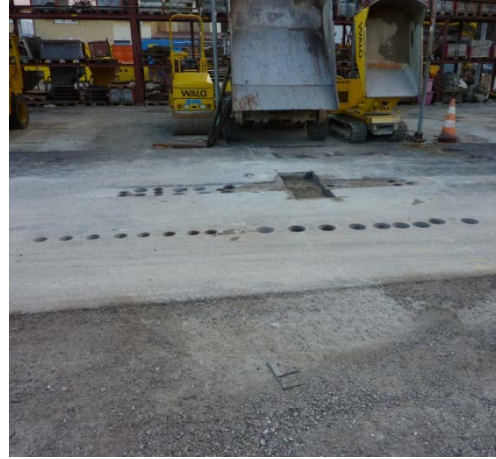
Abb. 16 Geschädigter Mittelbereich des Testfeldes mit entnommenen Proben
