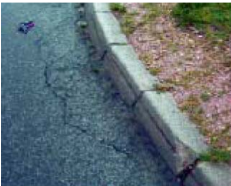
Abb. 4.32 Belagsrisse an angrenzenden Bauteilen (Bild aus [13])
