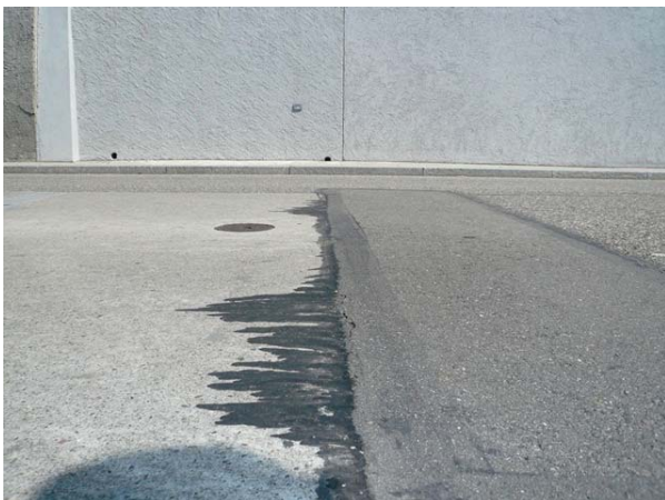
Abb. I.32 Anschlussfuge „Asphalt - Beton“.
