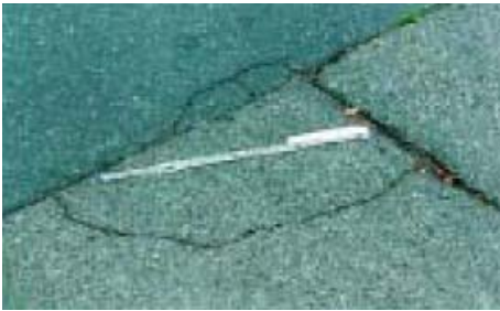
Abb. 4.31 Nachsacken der Asphaltplombe einschliesslich der Nebenbereiche (Bild aus [13])
