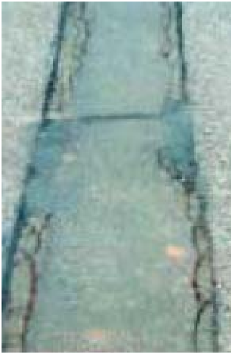
Abb. 4.30 Risse an Aufgrabungen (Bild aus [13])
