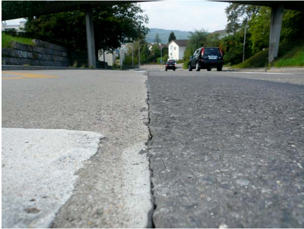
Abb. I.30 Anschlussfuge „Asphalt - Beton“.
