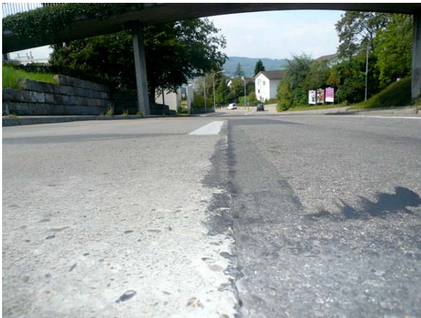
Abb. I.31 Anschlussfuge „Asphalt - Beton“.
