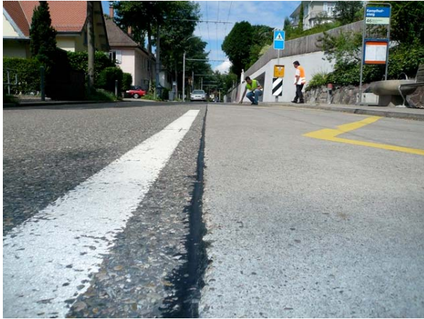
Abb. I.33 Anschlussfuge „Asphalt - Beton“.
