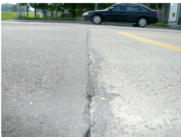
Abb. I.29 Anschlussfuge „Asphalt - Beton“.
