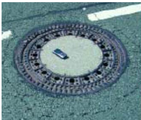
Abb. 4.34 Rissbildung und Absenkung um Einbauten (Bild aus [13])
