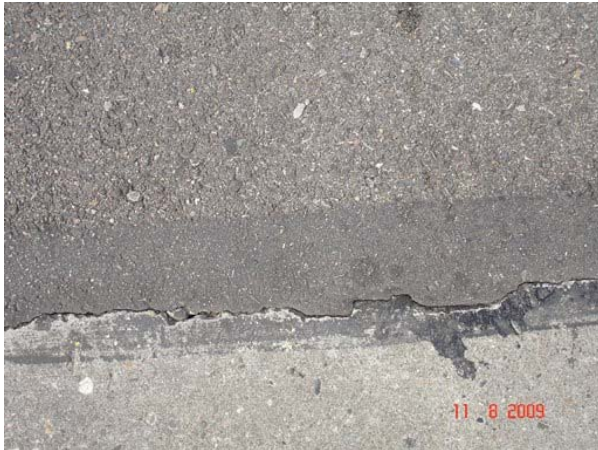
Abb. I.27 Anschlussfuge „Asphalt - Beton“.
