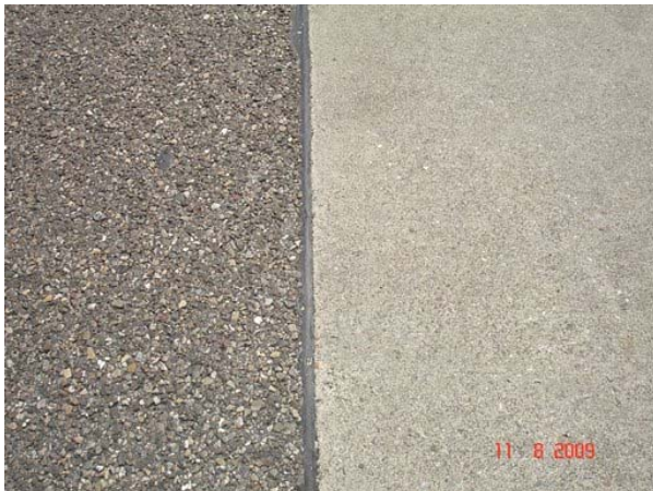
Abb. I.28 Anschlussfuge „Asphalt - Beton“.
