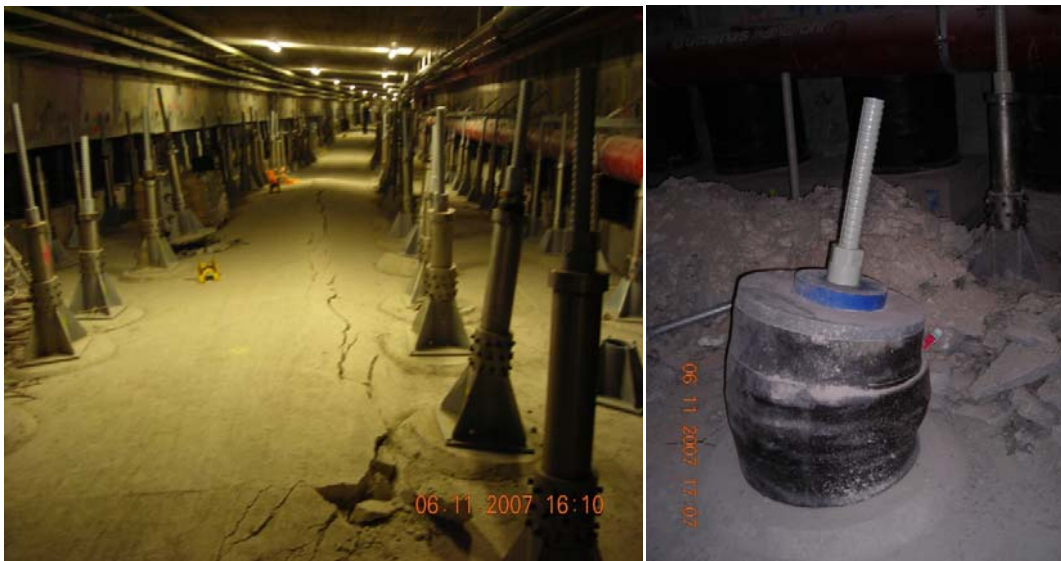
Abb. 1: Den Deformationen im Chienbergtunnel aufgrund von Gebirgsquellen im Gipskeuper wird durch Felsanker und Knautschkörper unterhalb der Fahrbahn begegnet.
